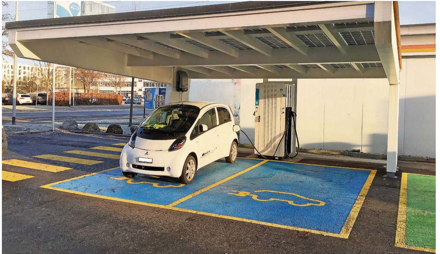
Diese Schnellladestation mit Solardach in Rotkreuz dient der Gemeinde Turbenthal als Vorbild.
